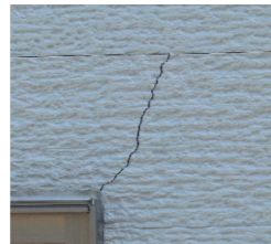
ひび割れ・反り
